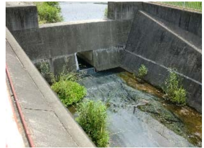
扇川への流出口付近（扇川側） 暑さで腐食したヒシのヘドロ かなりの腐食臭
