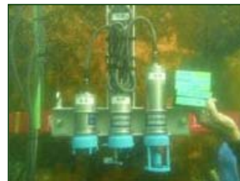
写真-3: 瀬木寄瀬東方灯標 (固定式装置)
