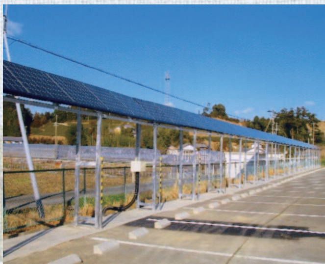
太陽光パネル
