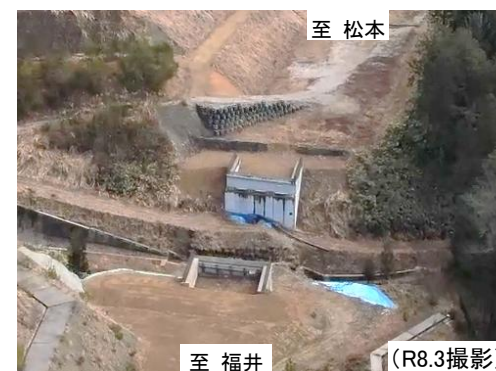
写真②: 稲部谷橋付近の状況
