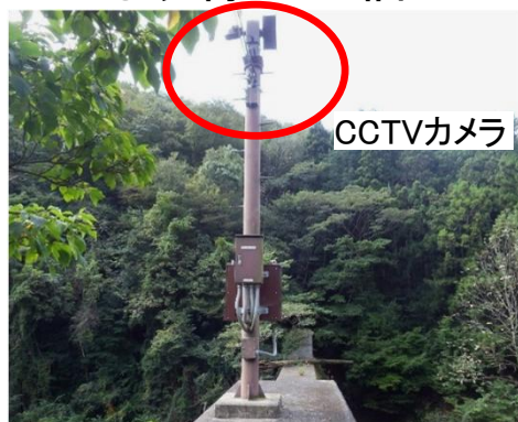
CCTVカメラ設置状況(深沢砂防堰堤) ふかさわ
