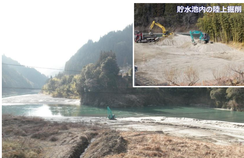
堆砂によるダムの機能低下の例 (湖内の陸上掘削)
