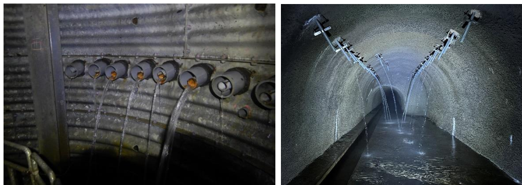
図3-1-2 集水井と排水トンネルの排水状況（山中ブロック）
