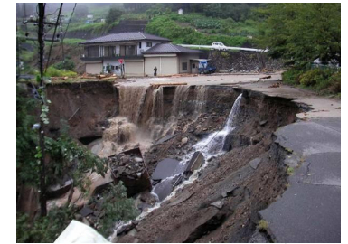
国道303号寸断(揖斐川町東津汲) ひがしつぐみ
