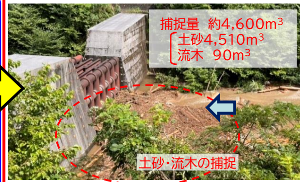
出水後: 令和5年8月16日撮影
