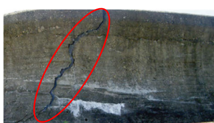
波返し部のひび割れ状況
