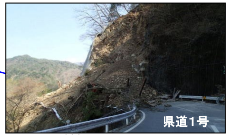
2017年 平岡地区での斜面災害発生事例 ・県道1号で道路法面が崩落し、約4カ月間にわたって通行止。
