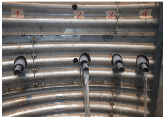
地下水の排除状況（集水井）
