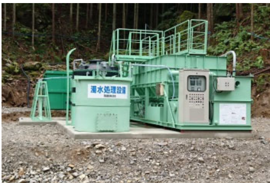
濁水処理施設
