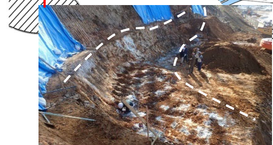
下部工掘削箇所に出現した変質安山岩
