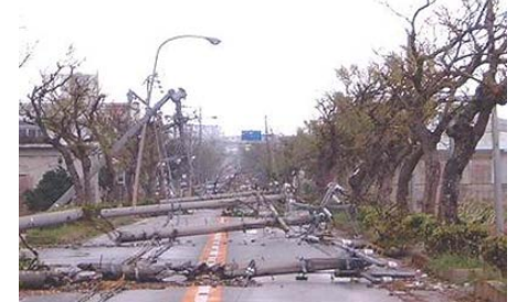
被災イメージ(写真は沖縄県宮古島) 電柱が倒壊し、緊急車両の通行に支障となる
