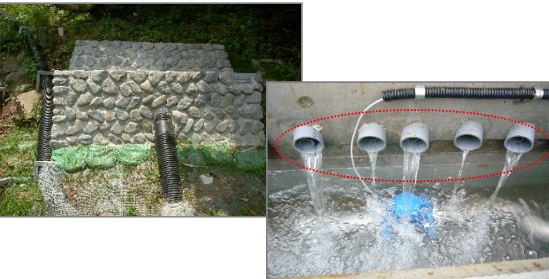
横ボーリング工施設と排水状況(大久保ブロック)
