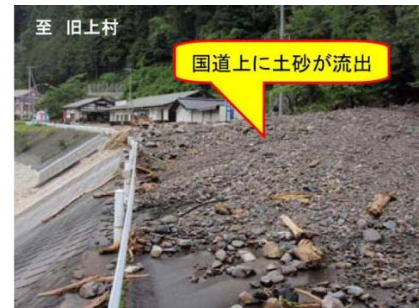
国道への土砂流出
