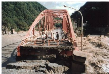
みぶがわばし 三峰川橋左岸の決壊状況 はせ (伊那市長谷)
