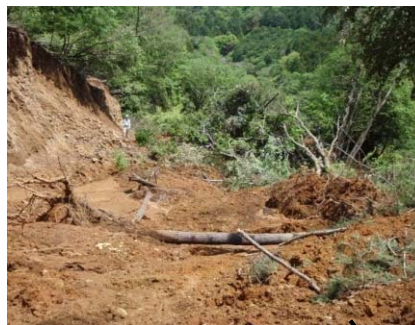
しもおのがわ 下尾野川での崩壊 (H24.5大雨)
