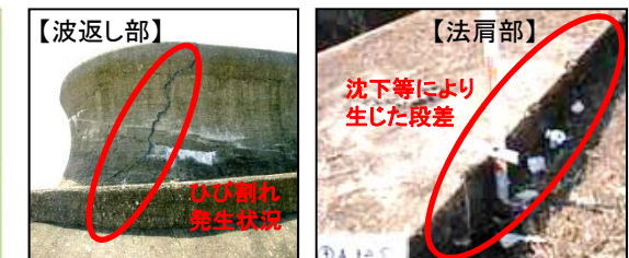
老朽化によるひび割れや沈下等により機能低下した堤防
