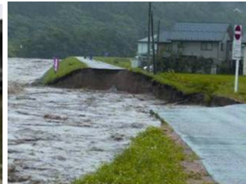
H18.7災害 堤防決壊(箕輪町松島地区)
