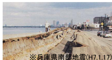
液状化で沈下した堤防の例
