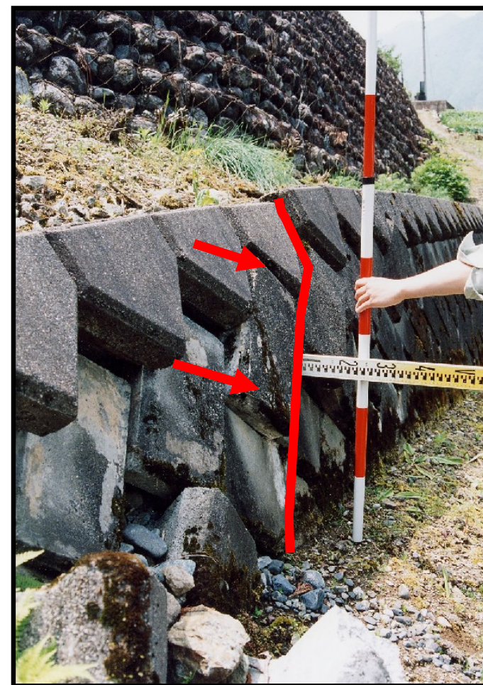
地すべり活動により押し出されたブロック積擁壁
