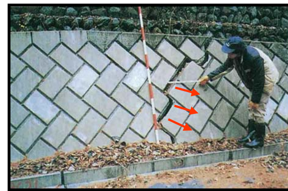
昭和58年9月 地すべり活動による 道路擁壁の押出し
