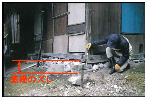
昭和57年8月 地すべり活動による 基礎の沈下
