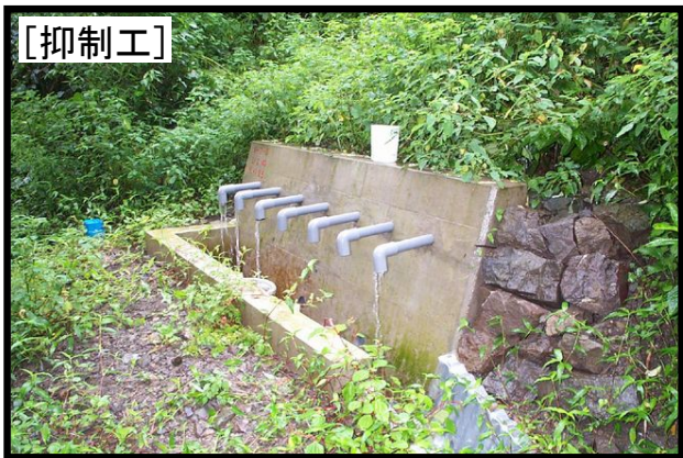
横ボーリング工による排水の状況
