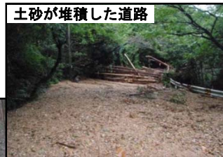
土砂が堆積した道路
