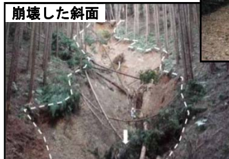
崩壊した斜面
