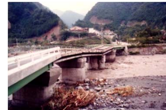
県道の欠損状況
