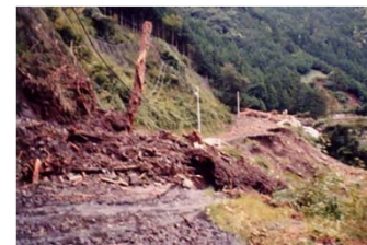
関の沢橋の被災状況
