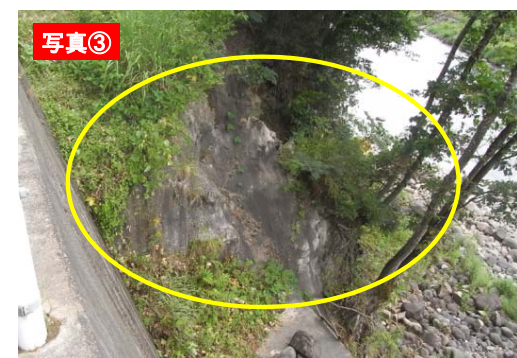
モルタル吹付の欠落・崩壊が発生。H25現地調査結果
