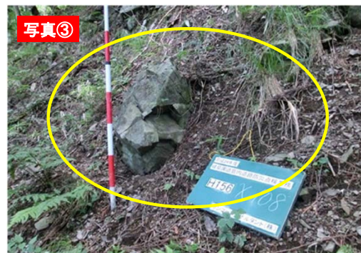
写真③ 終点側斜面の浮石. H24防災点検結果
