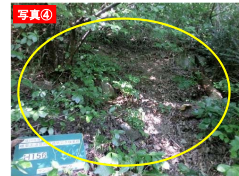
小規模崩壊跡地. H24防災点検結果
