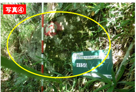
写真④ 落石防護柵未施工部の斜面下部の転石. H24防災点検結果
