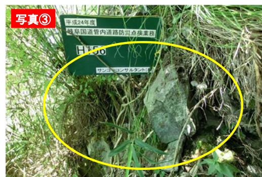
写真③ 落石防護柵未施工部の斜面下部の浮石. H24防災点検結果
