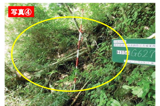
既存の石積み擁壁で老朽化が進行。H24防災点検結果
