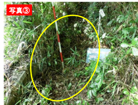
落石防護柵のポケット部に土砂が堆積. H24防災点検結果
