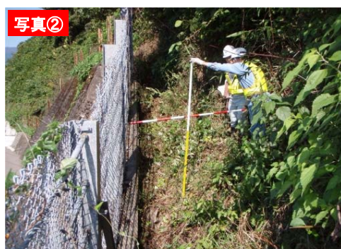
落石防護柵の設置. H23防災点検結果
