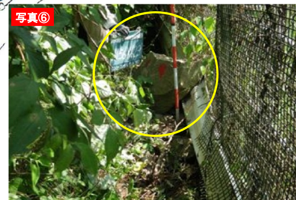
落石の継続的な発生や堆積土砂の増大。H24防災点検結果
