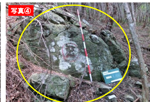
写真④ 終点側斜面の転石. H24防災点検結果
