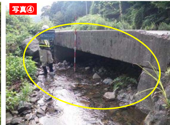
写真④ 土石流、流木に対する余裕高が不足.H24防災点検結果
