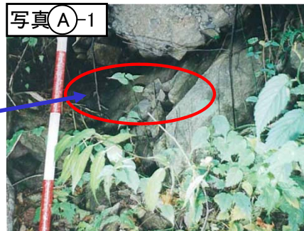
ポケット式ロックネットの支柱基礎部の崩壊
