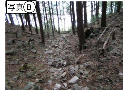
ストーンガード背面の崩壊
