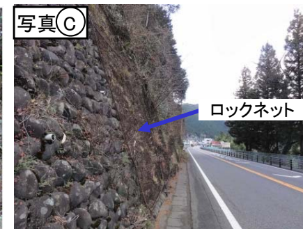
老朽化したロックネット
