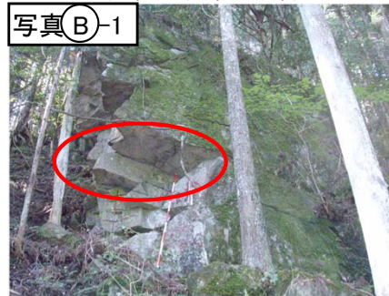
斜面上方の亀裂岩盤
