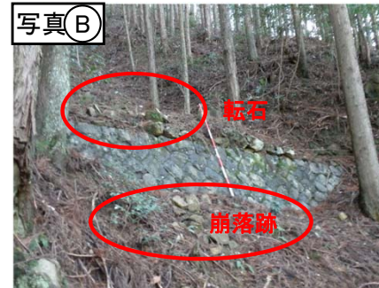
ストーンガード背面の崩落跡
