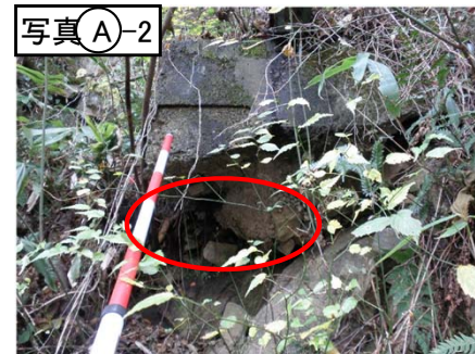
ポケット式ロックネット背面の崩壊
