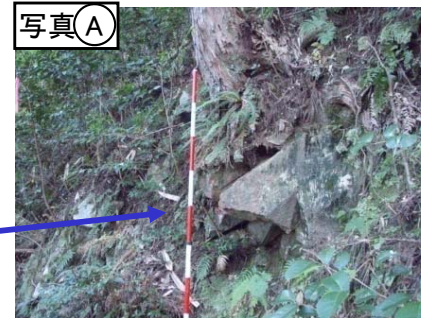
浮石化した露岩・表層崩壊跡
