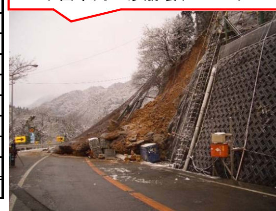
下呂市内土砂崩壊(H16.2.6)
