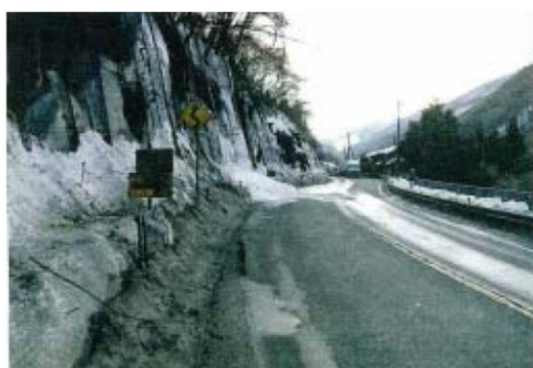
63cmの積雪により 雪崩発生
