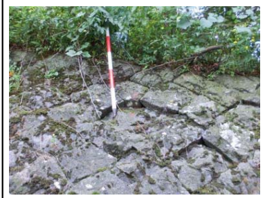
写真⑤: C防災カルテ箇所(レベルⅡ)(擁壁) ・石積のズレによる隙間 ・石積の目地の間隙
