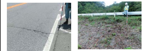
写真②: 防災カルテ箇所(レベルⅡ)(盛土) ・擁壁末端部の排水溝の破損 ・路肩の亀裂
