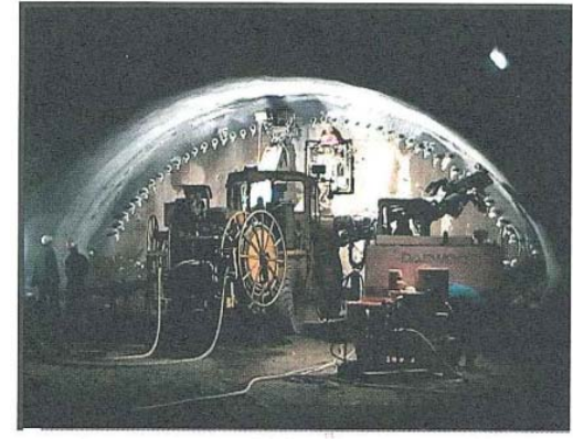
長尺鋼管フォアパイリングのイメージ図と施工状況写真
