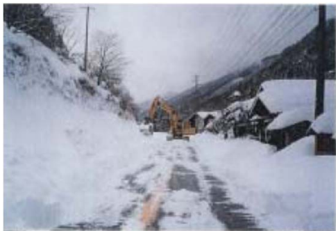
56cmの積雪により 雪崩発生
