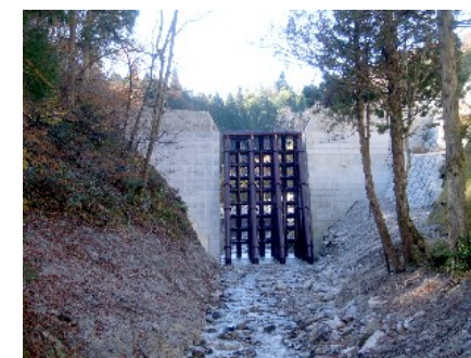
せとだに 瀬戸谷第1砂防堰堤(H23年完成)
