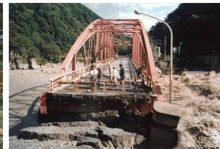
三峰川橋左岸の決壊状況 (伊那市長谷)
