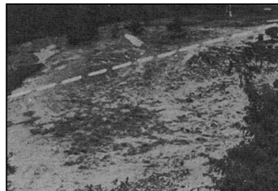
川上地区の被災状況
