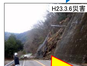
国道151号落石崩土
