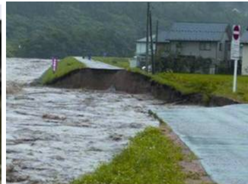
H18.7災害 堤防決壊(箕輪町松島地区)
