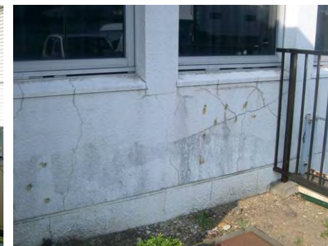
外壁（ひび割れ）
