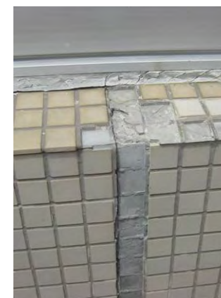
外壁（タイル剥落）
