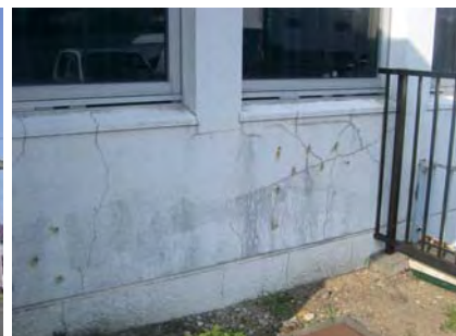
外壁 (ひび割れ)
