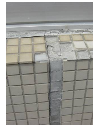
外壁（タイル剥落）
