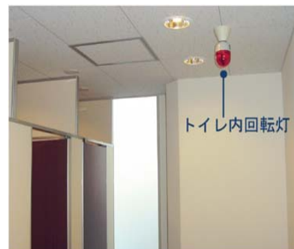
トイレ内回転灯 火災時に点灯し、聴覚障害者に警告
