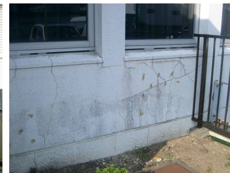
外壁（ひび割れ）
