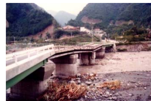
県道の欠損状況
