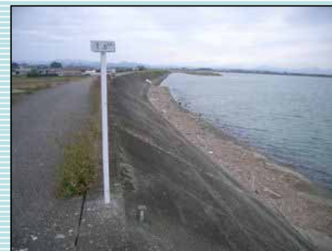
高潮堤防老朽化の状況 (宮川左岸1.6k付近)
