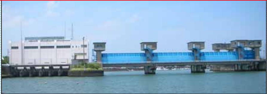
勢田川排水機場・防潮水門(勢田川0.8k付近)
