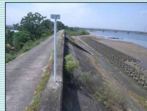
高潮堤防老朽化の状況 (雲出古川右岸0.6k付近)
