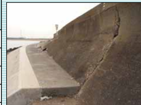
高潮堤防老朽化の状況 (鈴鹿川左岸0.0k付近)
