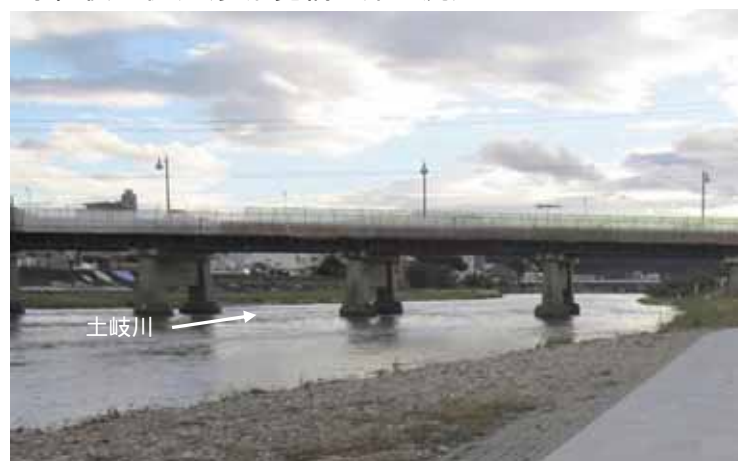
出水直後の状況(多治見橋右岸上流)
