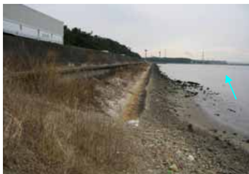
高潮堤の老朽化状況 (-0.2k付近)
