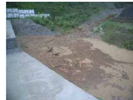
第2波土石流発生状況
