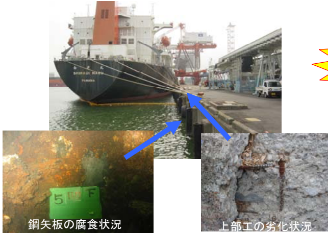
○既存の中央2号岸壁の劣化状況
