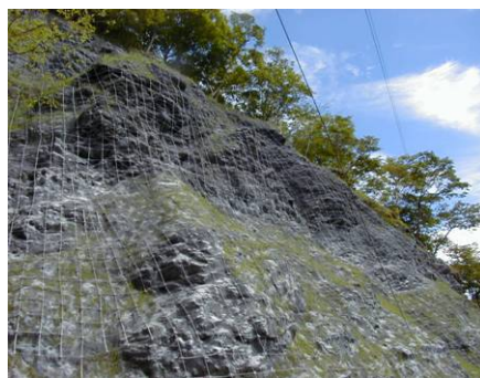
同左(落石防止柵工)
