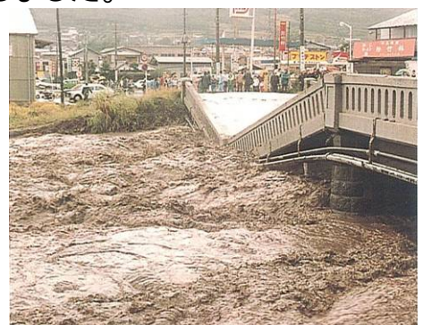
潤井川本川野中橋の被災状況(S54)
