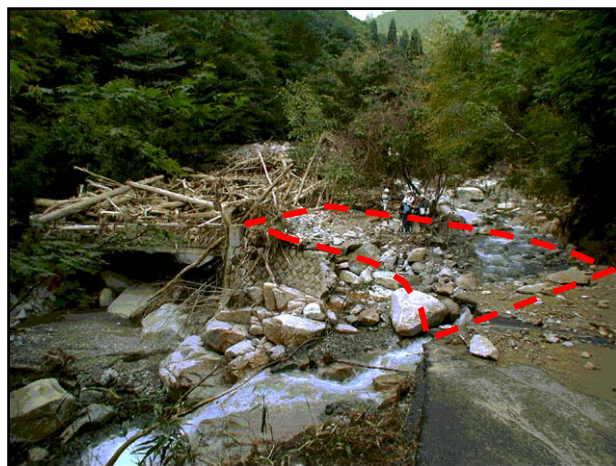
中津川支川一の沢の土砂流出状況
