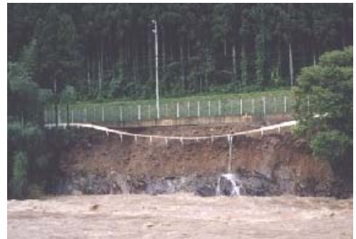
H11出水被災状況
