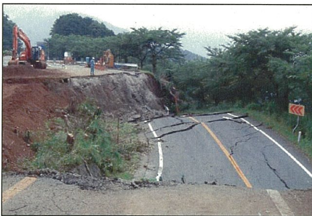
平成19年7月23日に伊豆市土肥で発生した地すべり(国道136号)
