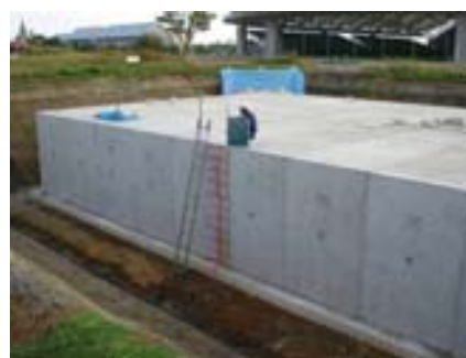
雨水貯留タンク
