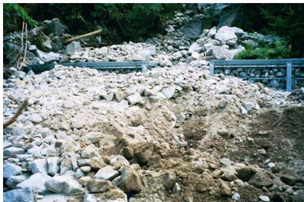
町道被災状況
