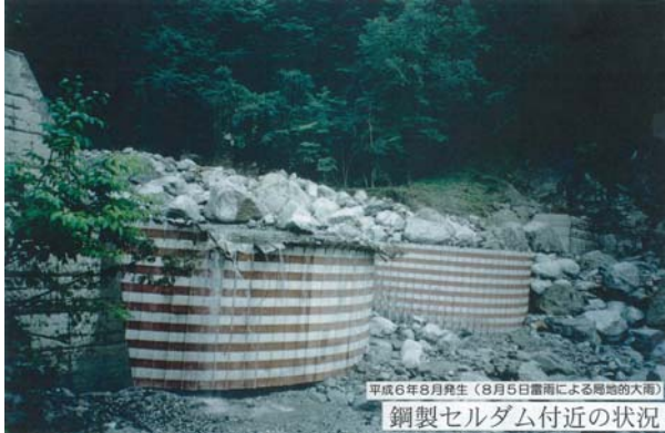
土石流により満砂した砂防えん堤
