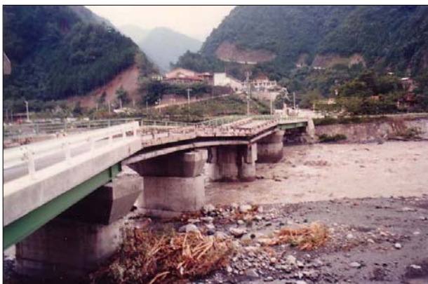
関の沢橋の被災状況
