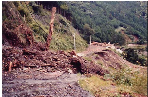
県道の欠損状況
